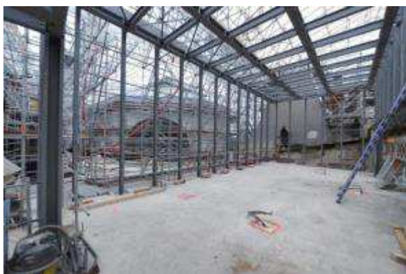
Structure métallique composée en partie de profilés PRS pour les poteaux (Photo : Michael Tubiana)
