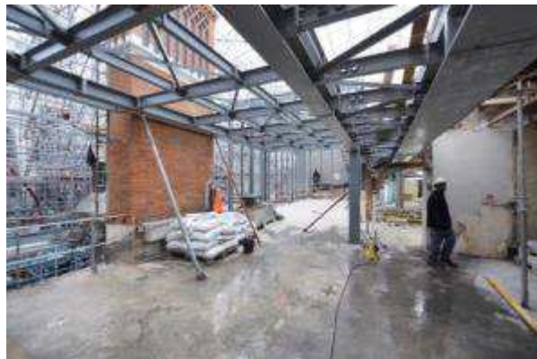
Poutre de jonction doublée par assemblage de deux profils métalliques (Photo : Michael Tubiana)
