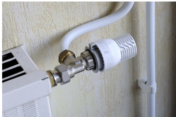
Les robinets manuels ont été remplacés par des kits Sensity, comprenant corps et tête thermostatiques.
