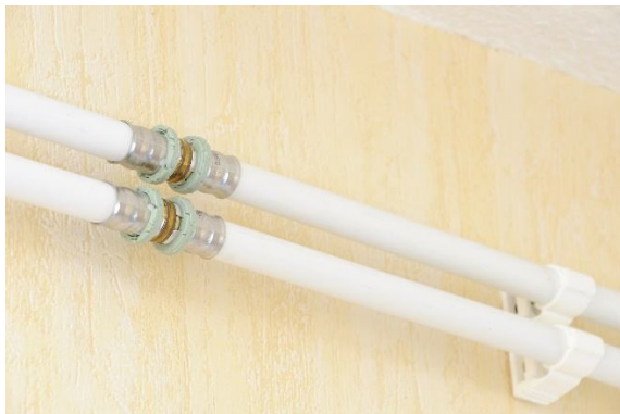
Les réseaux secondaires ont été remplacés par le système SkinPress : raccords à sertir et tubes multicouche.
