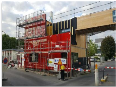
Poste de sécurité incendie et anti-malveillance CHI André Grégoire, Montreuil (93)
