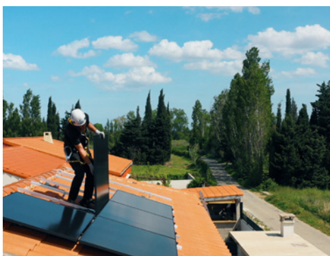
Installation de panneaux photovoltaïques à Saint-Feluil-d'Avall (66) par Hellio et un partenaire local
