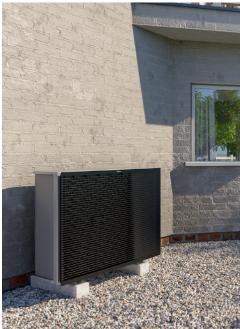
Pompe à chaleur Daikin Altherma 3 H HT, marque partenaire de Hellio
