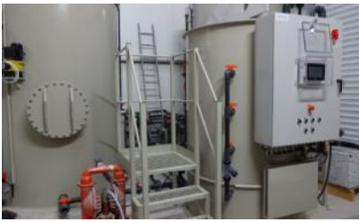
Station de traitement des eaux usées en 2016
