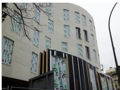
L'industrialisation des murs cintrés en ossature bois a été poussée au maximum en intégrant en usine les 600 menuiseries, leurs volets et leurs garde-corps. Crédit photo : Manuel Panaget
