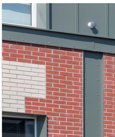
Dans les recouvrements viennent se loger des bandes d'aluminium laquées grises qui reconstituent l'aspect de la structure métallique d'origine. Elles sont ornées de cabochons en aluminium imitant les rivets style Eiffel.
