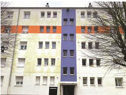
L'encrassement des façades fait partie des premières dégradations qui peuvent toucher les murs extérieurs d'une maison ou d'un immeuble.
